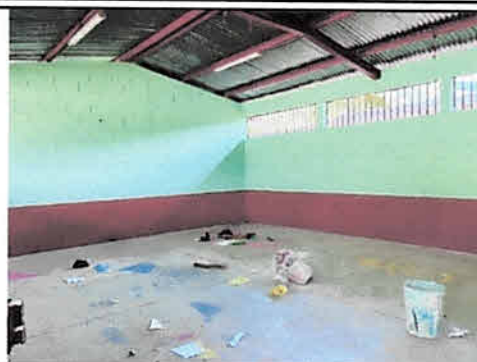
Foto 2: AULAS Pintura general paredes
